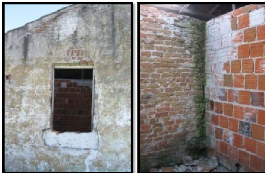
Figuras 58 e 59 - Detalhes da área interna da edificação evidenciando a mistura de elementos construtivos antigos e modernos. Fonte: Fotos da autora, 2011.
