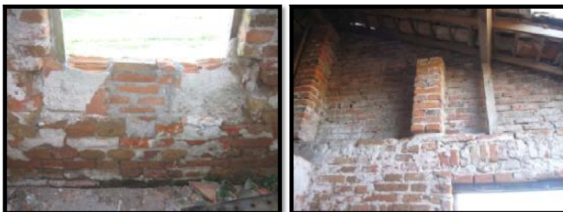
Figuras 56 e 57 - Detalhes da área interna da edificação evidenciando a mistura de elementos construtivos antigos e modernos. Fonte: Fotos da autora, 2011.
